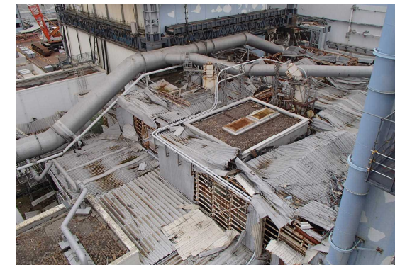
主排気ダクト（東側）
