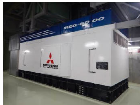
ガスタービン発電機 外観
