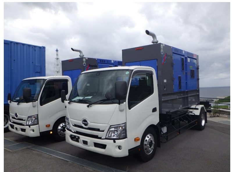
緊急時対策所用発電機
