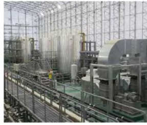
処理水タンク・供給タンク
