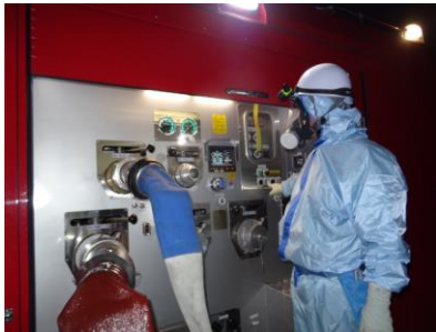
ポンプ起動操作（夜間）
