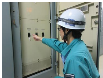
電源切替え操作
