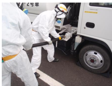
タンクローリへのホース接続
