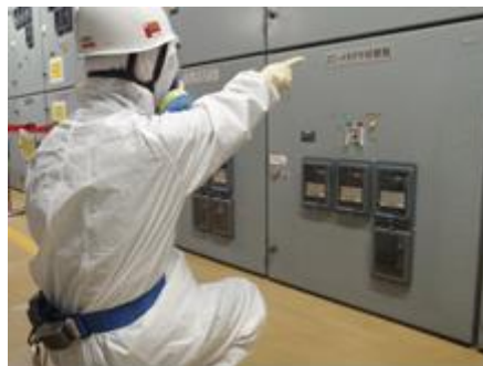
遮断器手動投入
