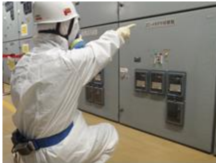
遮断器手動投入
