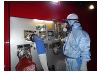
ポンプ起動操作(夜間)
