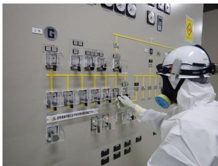
ガスタービン発電機起動操作
