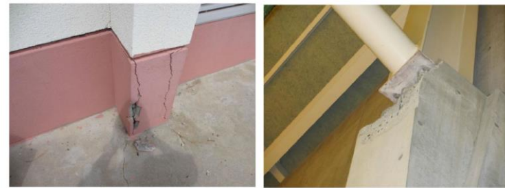
柱脚部コンクリートのひび割れ 支承部コンクリート側方破壊
