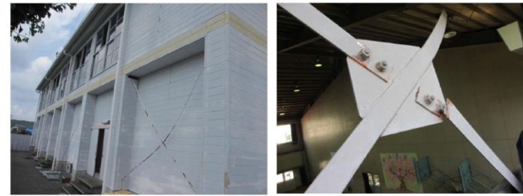
筋かい材の変形 ブレース孔欠損部の破断
