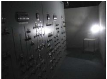
(上記撮影を逆方向から撮影、右端が照明設備)
