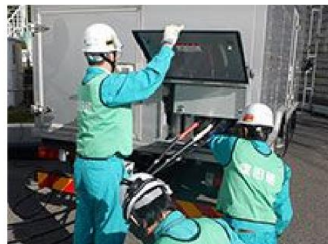
高圧発電機車を用いた電源供給訓練の状況 （写真は全交流動力電源喪失時を想定した電源ケーブル接続作業）
