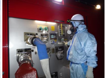
ポンプ起動操作（夜間）
