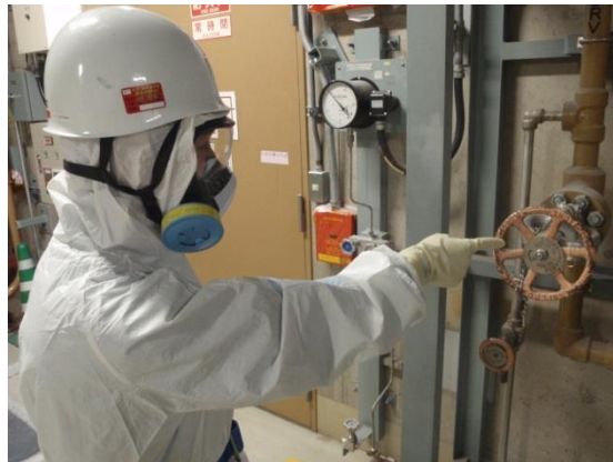
逃がし安全弁用窒素ガスボンベ(待機側)のインサービス
