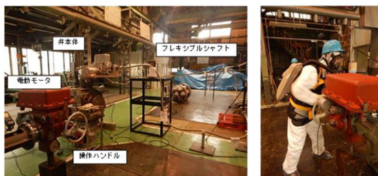
ベント操作（遠隔手動弁操作機構）
