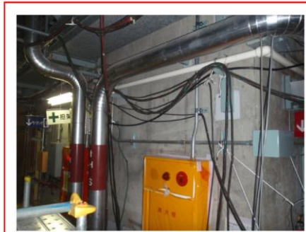
NGC N2ドライウエル 出口隔離弁 (第1弁 (D/W)) (MV 2 1 7 - 4) 遠隔操作位置 (設置予定場所)
