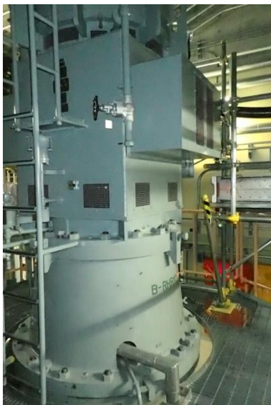
B-残留熱除去ポンプ
