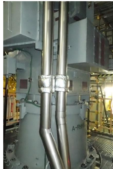
A-残留熱除去ポンプ
