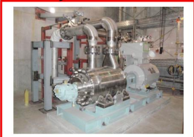
低圧原子炉代替注水ポンプ
