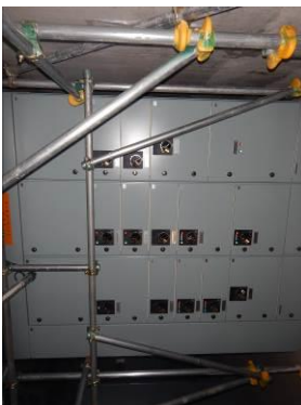
SA1コントロールセンタ 外観
