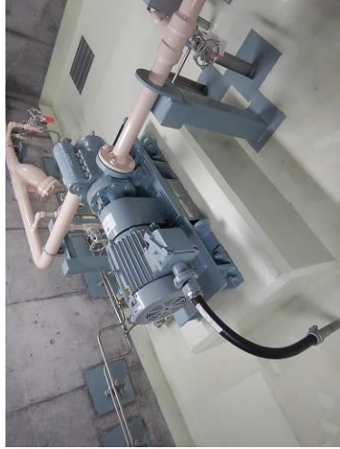
ガスタービン発電機用燃料移送ポンプ 外観
