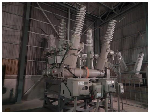
ガス絶縁複合開閉装置（66kV）
