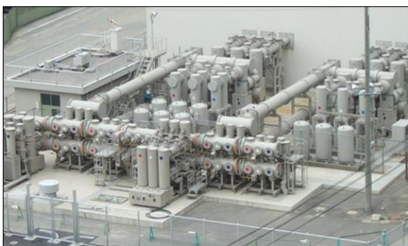
ガス絶縁開閉装置（220kV）
