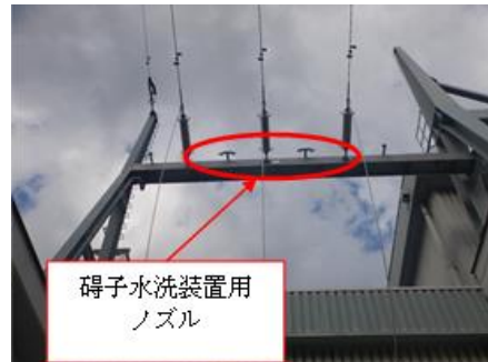
66kV 送電線（開閉所出口）
