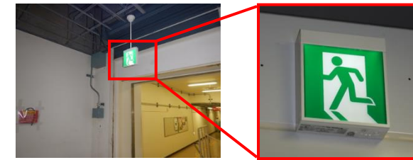
避難口誘導灯
