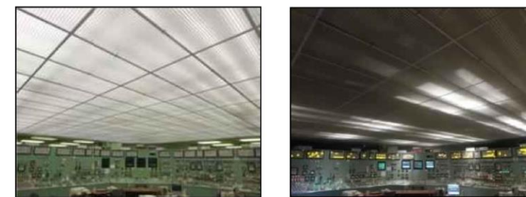
(通常点灯状態) (直流非常灯点灯状態)
