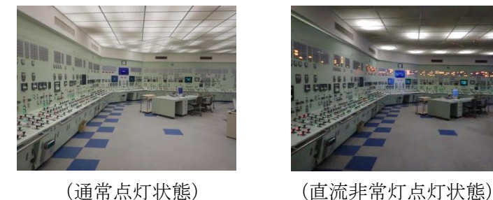
(通常点灯状態) (直流非常灯点灯状態)
