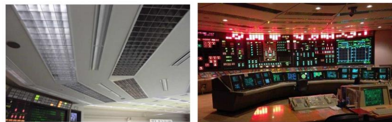
中央制御室照明
