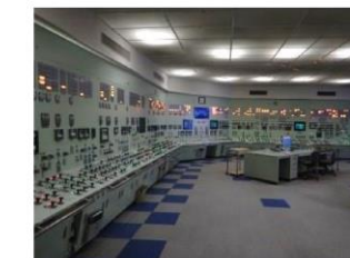
直流非常灯点灯時
