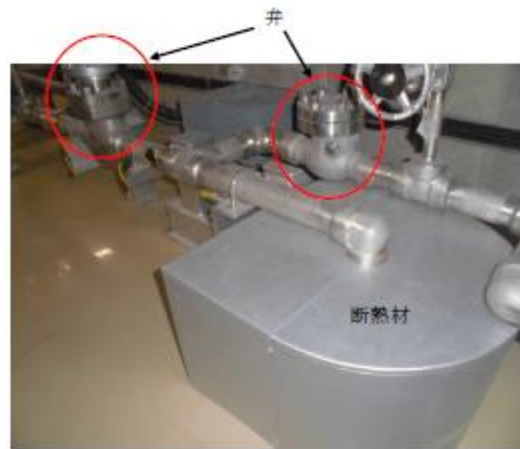
図5 断熱材近傍に設置される弁 (6号炉原子炉建屋4階 HPIN系)
