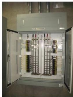
配線用遮断器の例 (ブレイカー)
