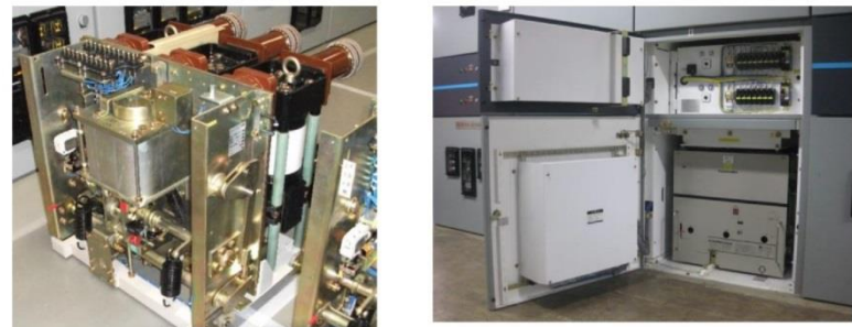
真空遮断器の例 (M/C)
