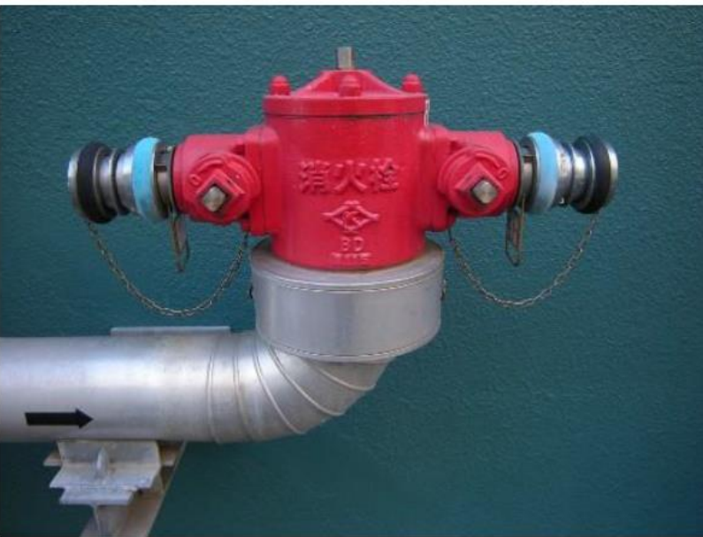
第 1-32 図：不凍式消火栓の設置状況
