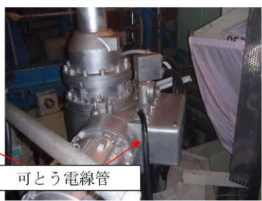
機器へのケーブル取合状況 (電動弁との取合)
