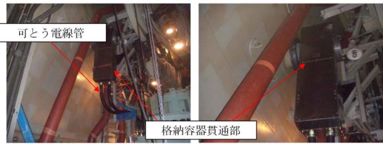
機器へのケーブル取合状況 (格納容器貫通部と電線管との取合)
