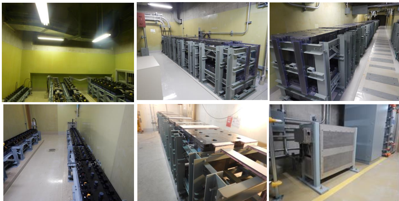
第1-39図 蓄電池の設置状況 (1 / 7)
