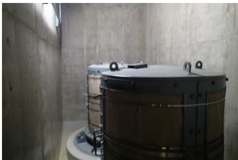
A-非常用ディーゼル発電機 給気消音器フィルタ
