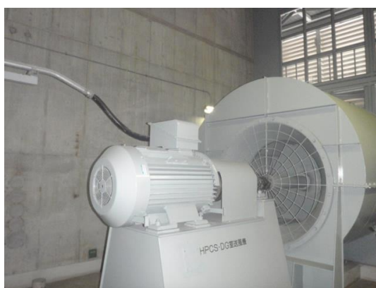
ディーゼル発電機室送風機室
