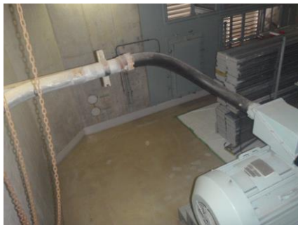
A-非常用ディーゼル発電機室送風機及び可とう電線管
