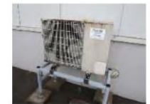
④-14 空調室外機
