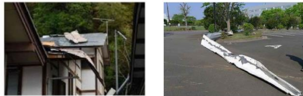
飛来物 (鋼板製屋根材) の衝突
