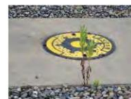
⑤-13 マンホール蓋
