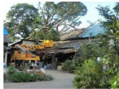
樹木の倒壊による小屋組の被害
