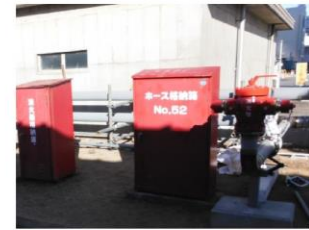
#153 消火設備格納箱
