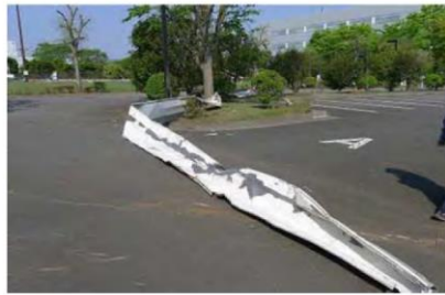
飛散した鋼板製屋根材
