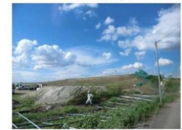
フェンスの倒壊
