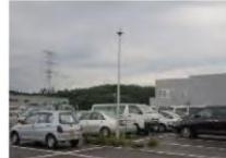
④-6 屋外照明
