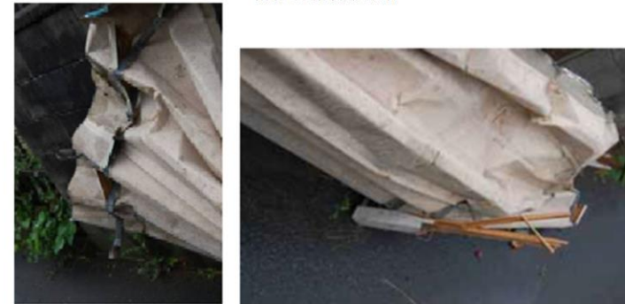
飛散した折板屋根の状況
