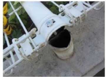
フェンス支柱部の破損
