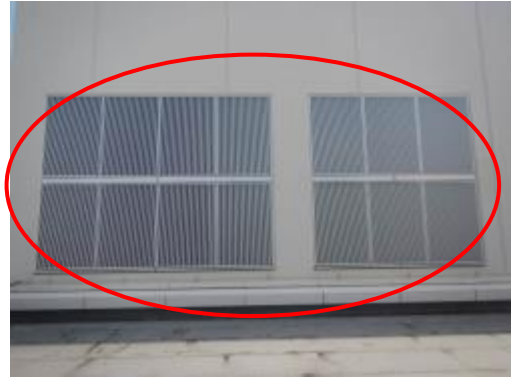
⑩ 廃棄物処理建物室外気取入ルーバ
