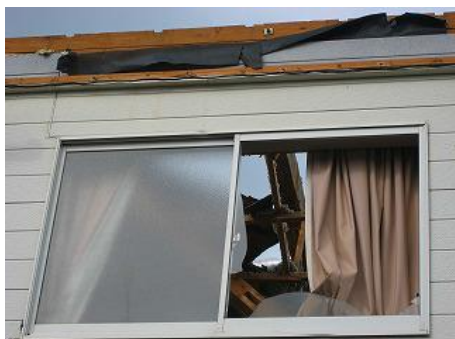
写真 19 窓ガラスの損壊
