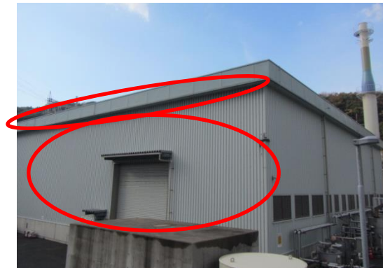
165 3号炉補助ボイラ
