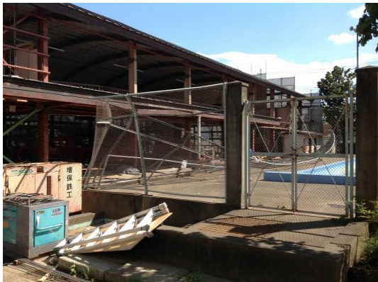
写真 5.2.19 フェンスの被害（工事中の構築物）
