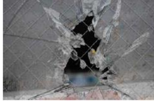
写真 3.4-36 ガラスへの飛来物の衝突痕
