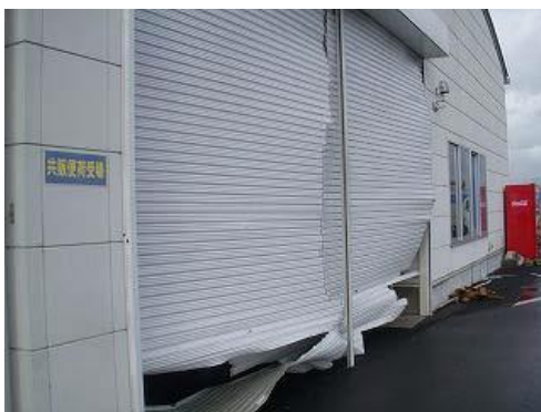
写真 10 シャッターの破損
