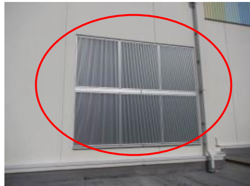
27 HPCS電気室空調換気系給気用格子
