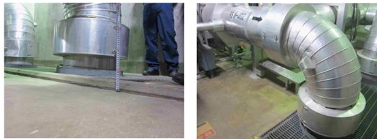
第2.3-2図 原子炉補機冷却海水系配管貫通部 (6号炉)
