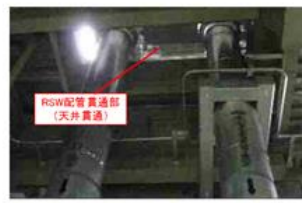
RCW配管貫通部 (天井貫通) 現場状況
