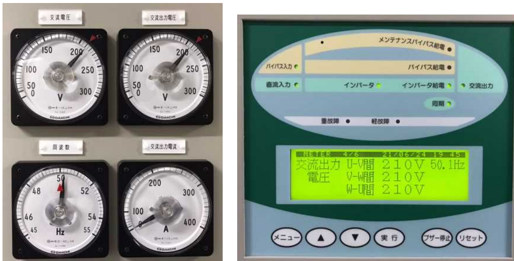
第7-1図 共用無停電電源装置（インバータ盤）の指示計とデジタルパネル
