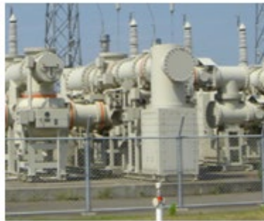
第 3-3-2 図 受電開閉設備のフェンス（小動物対策）
