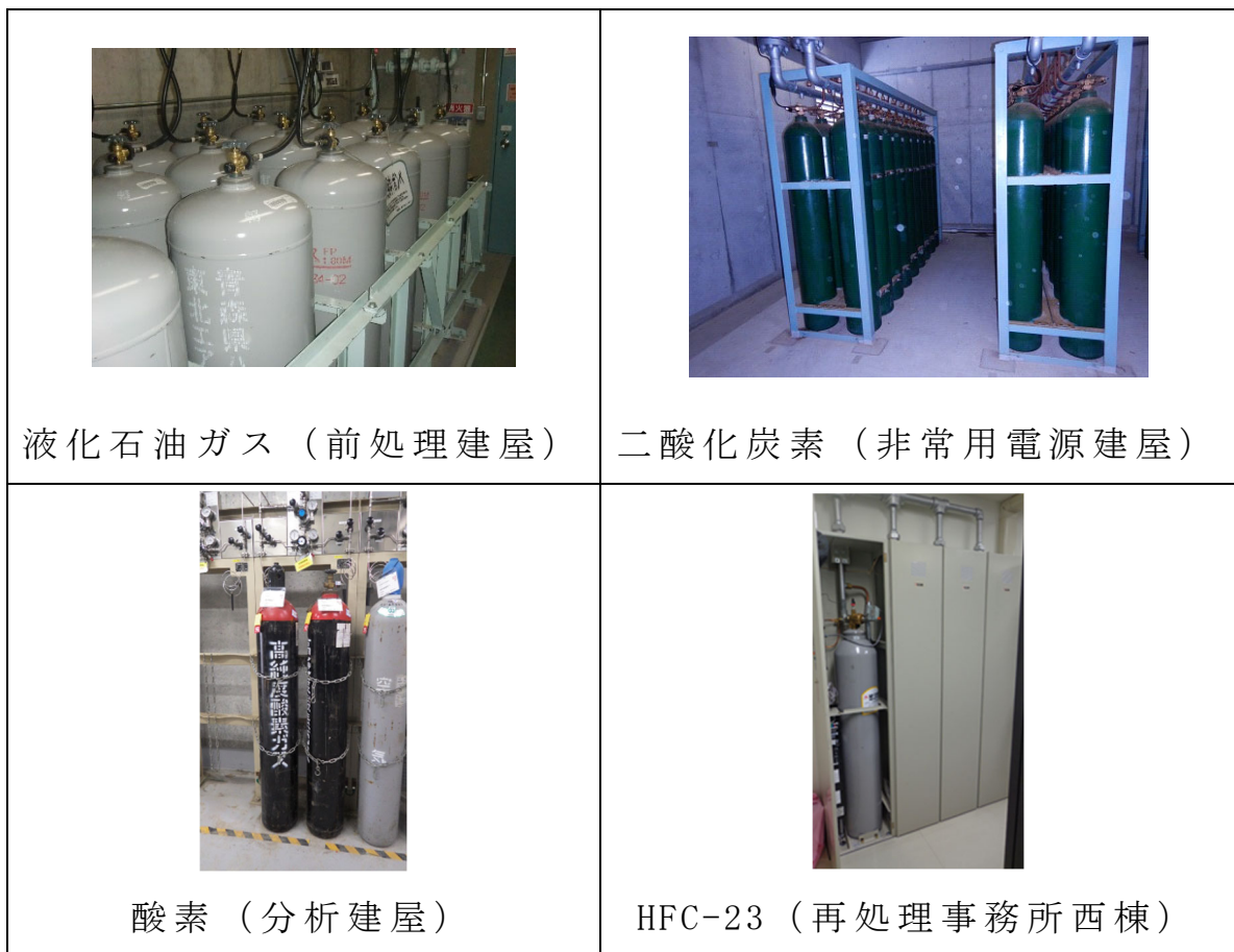
第2図 再処理施設における高圧ガス容器の保管状況
