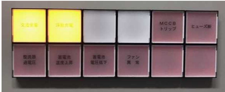
第 7 - 2 図 共用無停電電源装置（充電器盤）の警報表示窓
