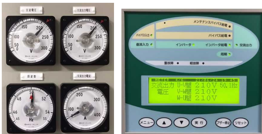
第7-1図 共用無停電電源装置（インバータ盤）の指示計とデジタルパネル
