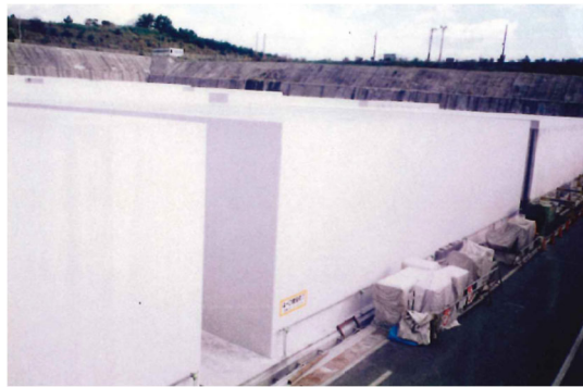
写真4 表面被覆状況(1号4-C)
