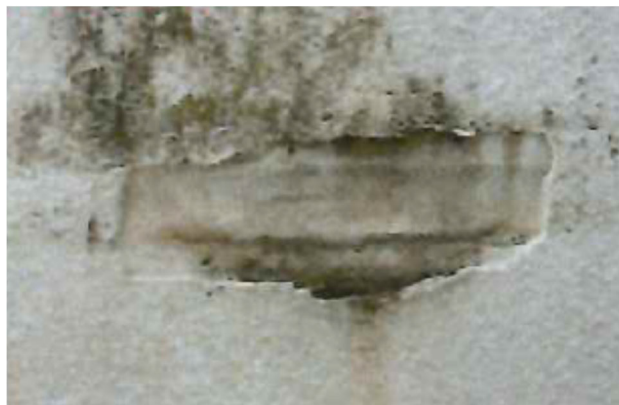
写真 10 表面被覆の剥離(1号 4-C 覆い側部)
