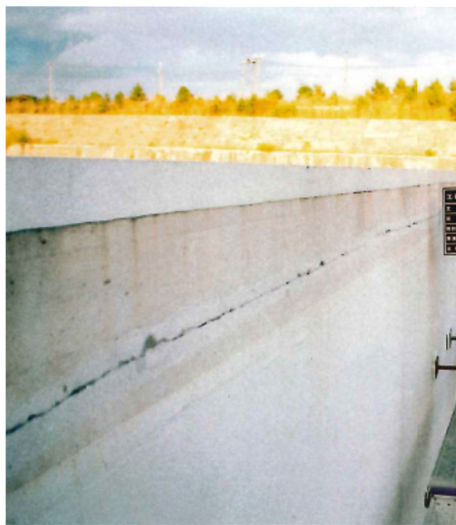
写真1 覆い側部のひび割れ状況
