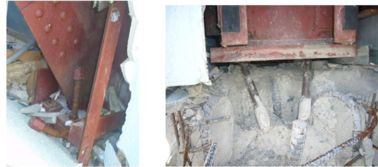
アンカーボルト引き抜け 柱脚部コンクリート破壊
