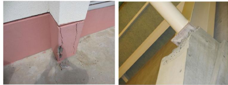
柱脚部コンクリートのひび割れ
