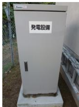
(非常用発電機の写真)
