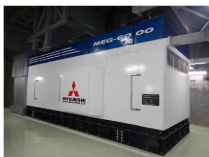
(常設代替交流電源設備の写真)
