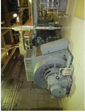
非常用ディーゼル発電機及び 高圧炉心スプレイス系ディーゼル発電機 外観
