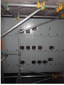
SA 2コントロールセンタ (イメージ)
