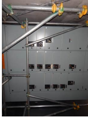
SA1コントロールセンタ 外観
