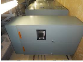
SA 電源切替盤 (イメージ)
