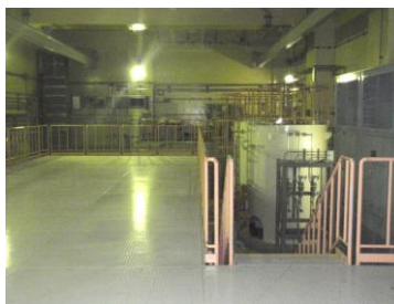
RCW サージタンク及び 計器ラック
