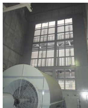
高圧炉心スプレイ系ディーゼル発電機室送風機及び火山灰対策（フレーム）
