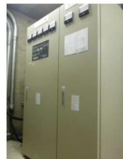
(無停電電源装置の写真)
