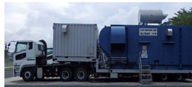
常設代替交流電源装置
