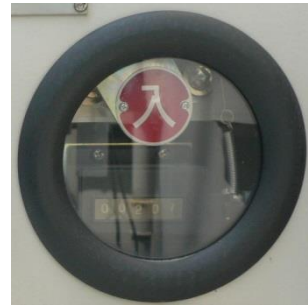
断路器投入状態
