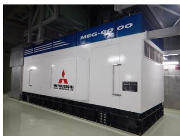
(常設代替交流電源設備の写真)
