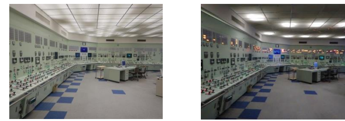
(通常点灯状態) (直流非常灯点灯状態)
