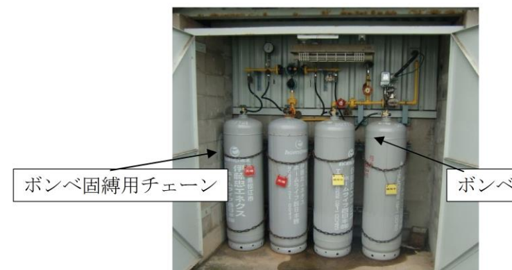
【補助ボイラプロパンガスボンベ庫】LPガス（補助ボイラ起動用）
