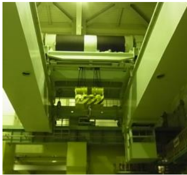
原子炉建物天井クレーン外観
