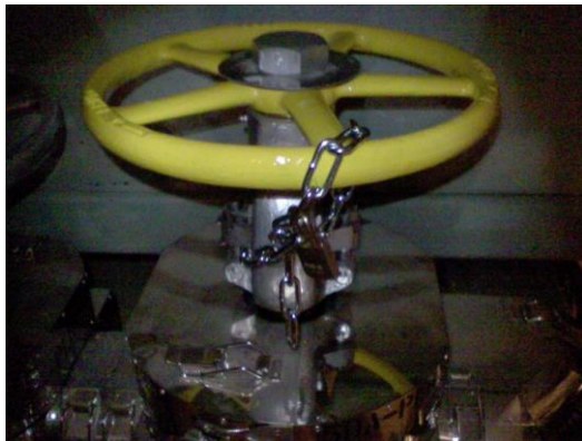
原子炉再循環系ドレン弁（A系）
