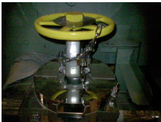
原子炉浄化系原子炉压力容器ドレン弁
