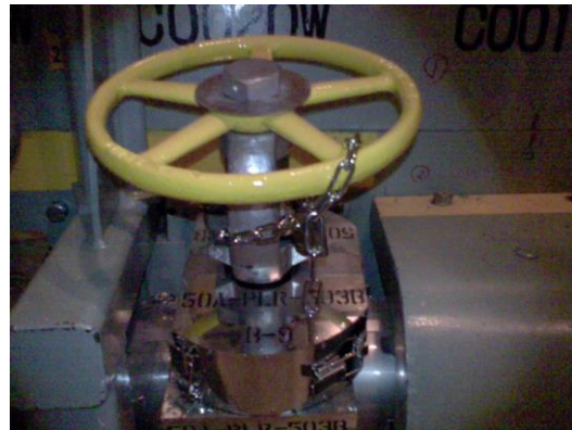
原子炉再循環系ドレン弁（B系）
