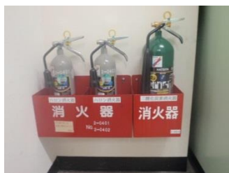
消火器設置状況
