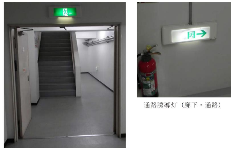
避難口誘導灯
