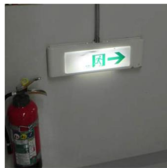
通路誘導灯 (廊下・通路)
