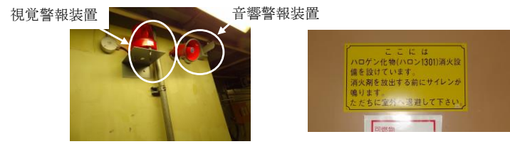
第 1-29図 全域ガス消火設備の職員退避警報装置の例
