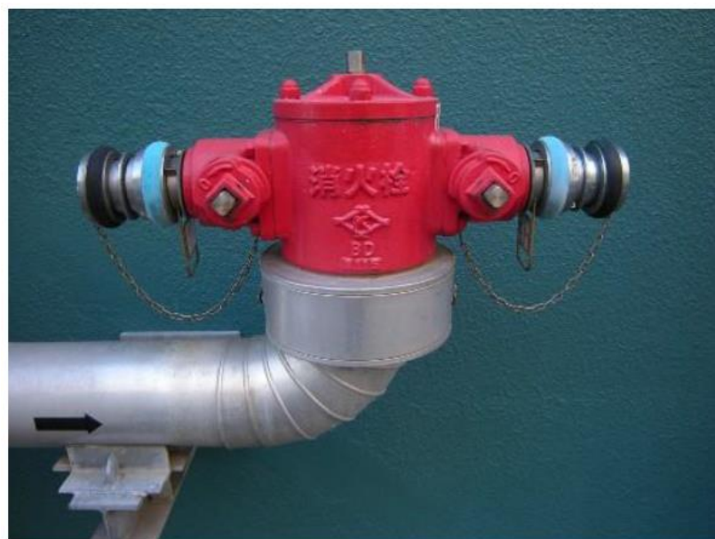
第 1-32 図：不凍式消火栓の設置状況
