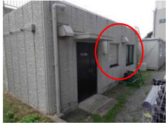
71 プロワ室ガラス窓
