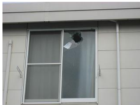
写真 27 窓ガラスの飛来物衝突痕
