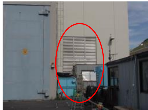
23 HPCS-DEG室排気用格子
