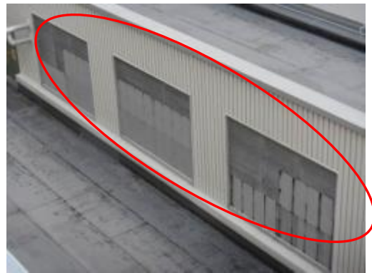
10 1号R/B空調換気系給気用格子
