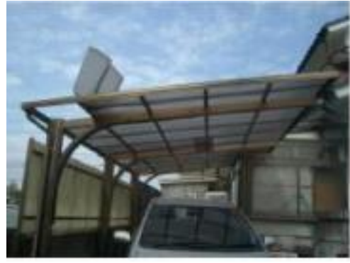
カーボード屋根の破損
