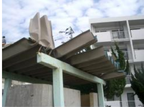
屋外トイレ屋根の損傷
