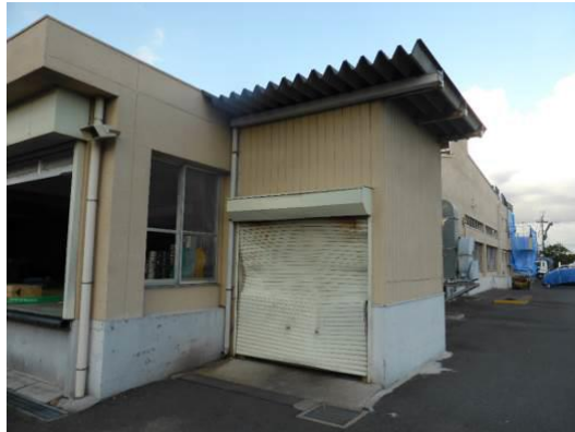
写真 4.1.30 シャッターの変形
