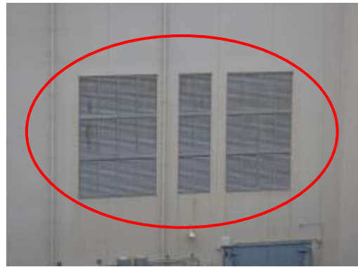
② A, B-非常用DG室外気取入ルーバ
