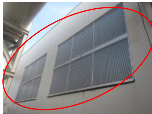
④ A-非常用電気室室外気取入ルーバ
