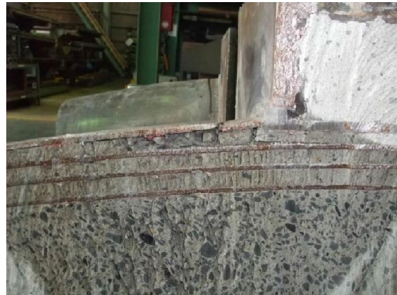
引張縁破断状況
