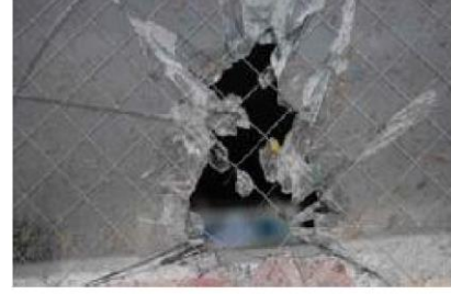
写真3.4-36 ガラスへの飛来物の衝突痕
