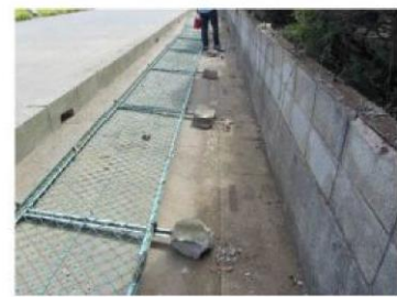
フェンスの倒壊
