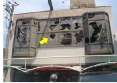
写真3.4-22 店舗の窓ガラスの被害状況
