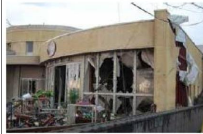
写真3.4-21 店舗の窓ガラスの被害状況
