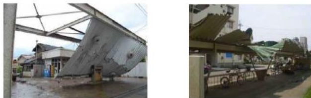
ガソリンスタンドの折板屋根の脱落
