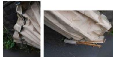
飛散した折板屋根の損傷状況
