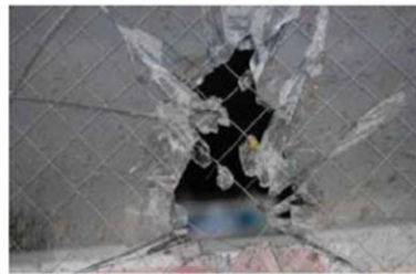
ガラスの被害状況(飛来物衝突痕)
