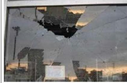
写真3.4-35 ガラスへの飛来物の衝突痕
