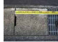
④-3 コンクリート板 (排水溝蓋)
