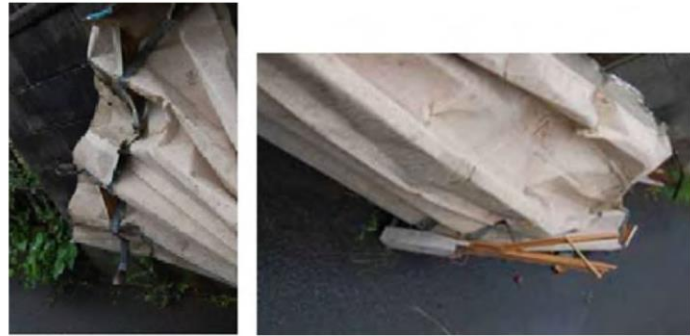
飛散した折板屋根の状況
