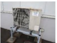
④-14 空調室外機
