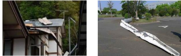
飛来物 (鋼板製屋根材) の衝突
