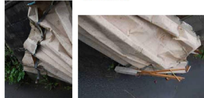
飛散した折板屋根の状況
