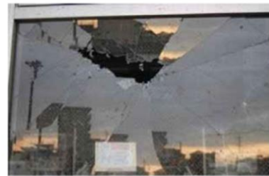
ガラスの被害状況(飛来物衝突痕)
