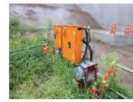
③-3 仮設分電盤
