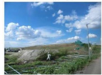
フェンスの倒壊
