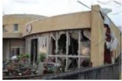
店舗の窓ガラスの被害状況
