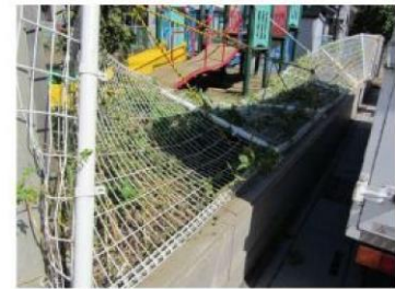
フェンスの変形
