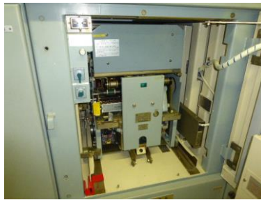
気中遮断器の例 (ロードセンタ)
