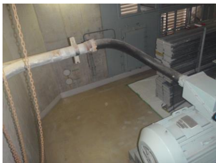
A-非常用ディーゼル発電機室送風機及び可とう電線管
