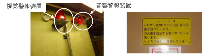
第 1-29図 全域ガス消火設備の職員退避警報装置の例
