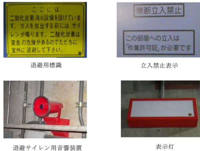
第1-32図 二酸化炭素自動消火設備（全域）の退避警報装置の例
