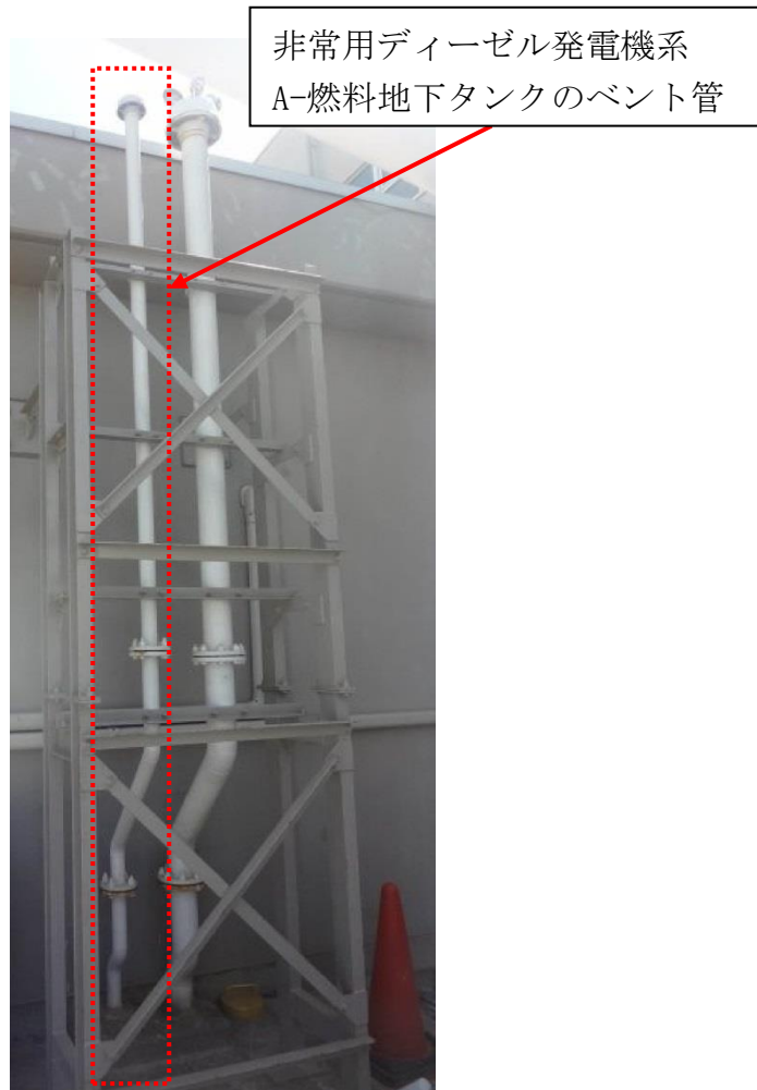
図 2-4 現場確認結果 (例) 非常用ディーゼル発電機系 A-燃料地下タンクベント管設置箇所 (屋外 EL8500)
